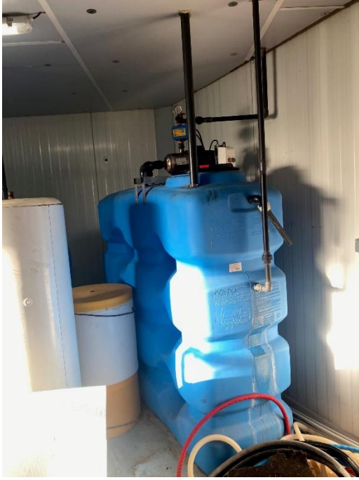
Cuve de récupération d'eau de 5 000 L
