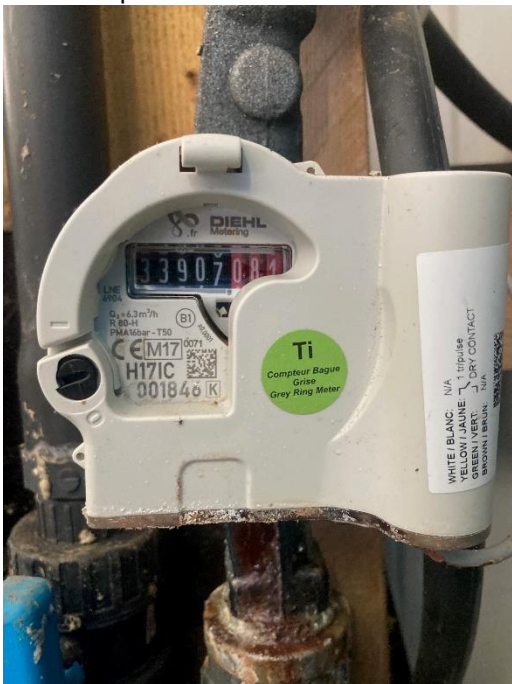
Compteur du puits
