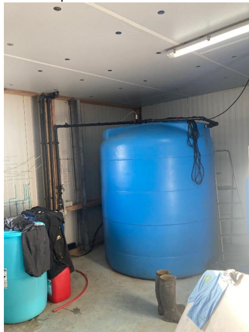
Cuve de récupération d'eau de 2 000 L
